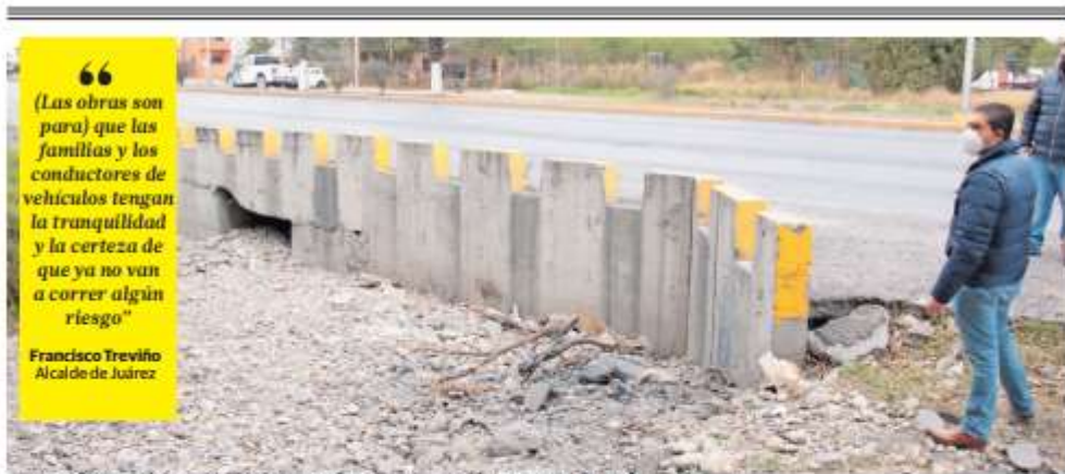
El Alcalde de Juárez supervisó la zona donde serán realizadas las obras de drenaje pluvial. Foto: Espinal
